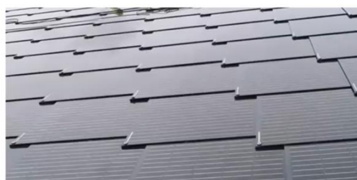
La centrale photovoltaïque du marché Saint-Charles de Perpignan est équipée de grandes tuiles PV SUNSTYLE (fabriquées en France à Châtelleraut/Poitiers)
